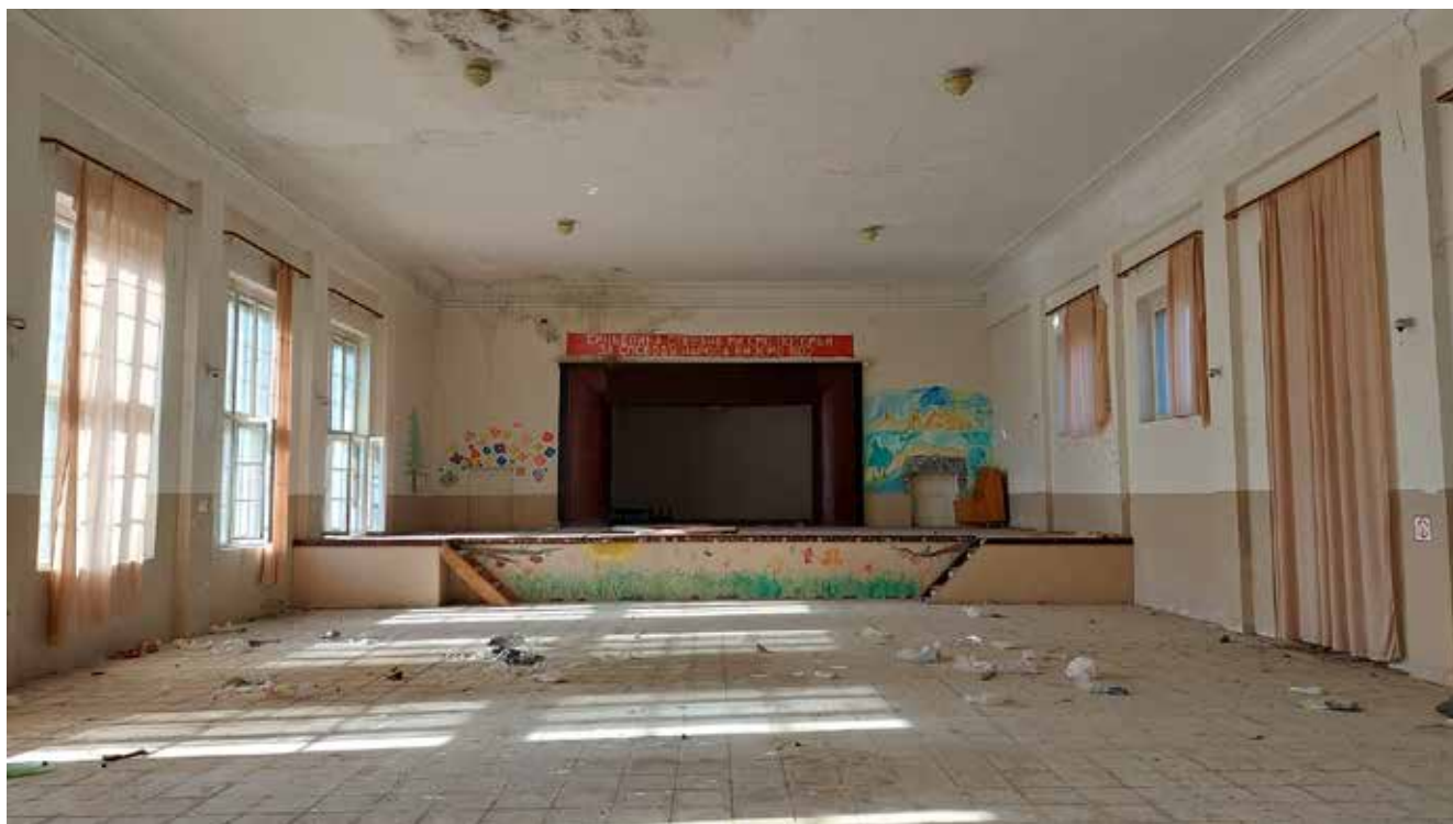
4. Главна сала дома културе у селу Каменица (фебруар 2022) 4. Main Hall of the Cultural Center in the Village of Kamenica (February 2022)
